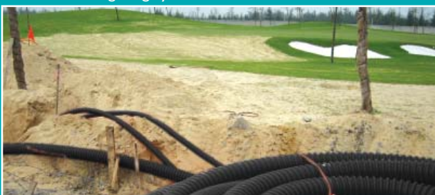
Hệ thống điện chiếu sáng tại các sân golf Lighting system in golf-court
