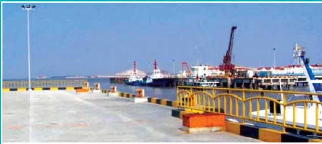
Hệ thống cáp ngầm tại cảng Underground cable system in ports
